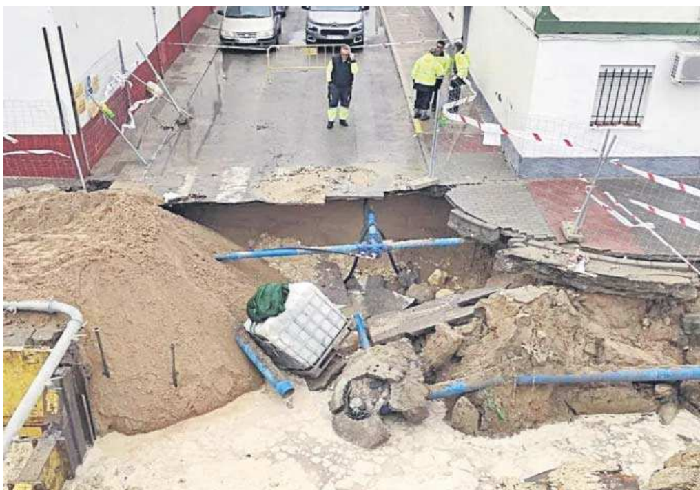
El hundimiento del acerado llega hasta las viviendas de la avenida.
