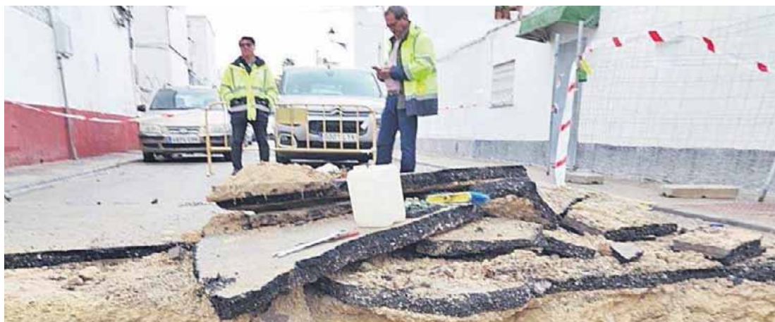
La calzada de la avenida de la Bajamar, tras el reventón ocurrido el pasado miércoles.
