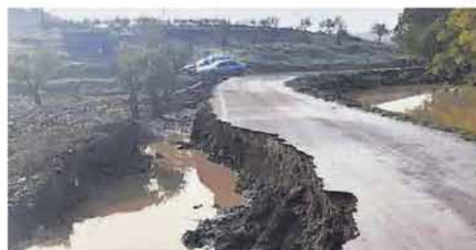
Estado de la carretera entre Cimballa y Llumes, ayer.
