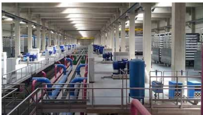
Interior de la desaladora de Águilas (Murcia), construida por Sacyr y Ferrovial. Cedida por Sacyr
